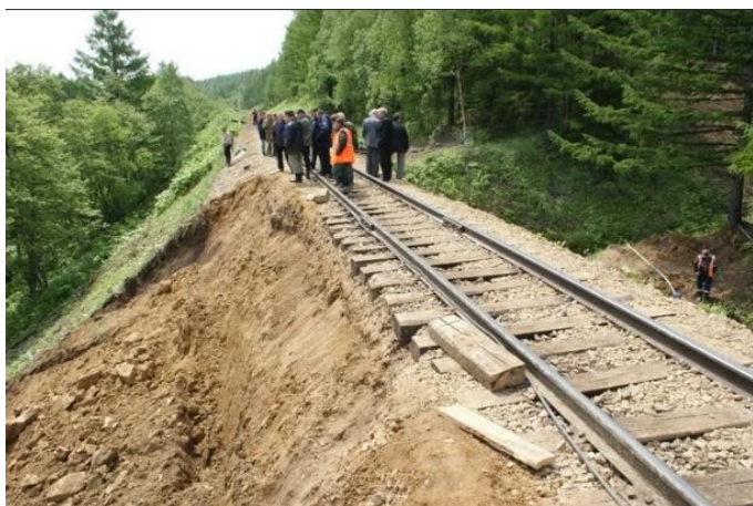
Рисунок 1 – Пример оползания откосов железнодорожного полотна
