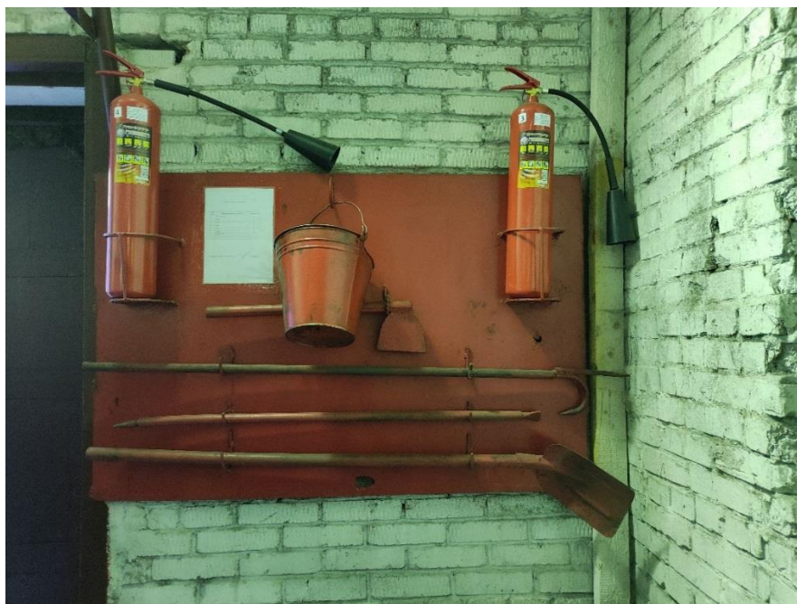
Рисунок 2 – Пожарный щит в месте складирования ГСМ
