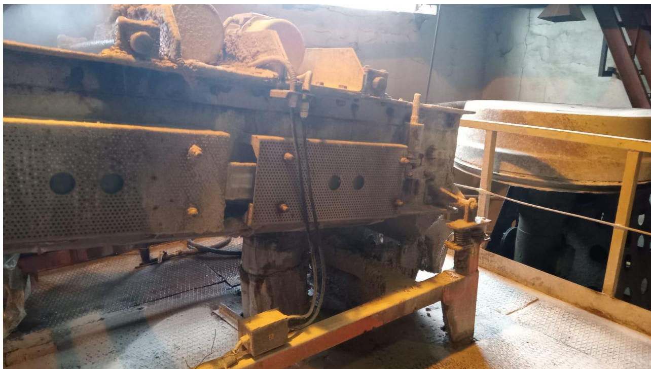
Рисунок 1 – Оборудование, имеющее признаки износа или дефектов
